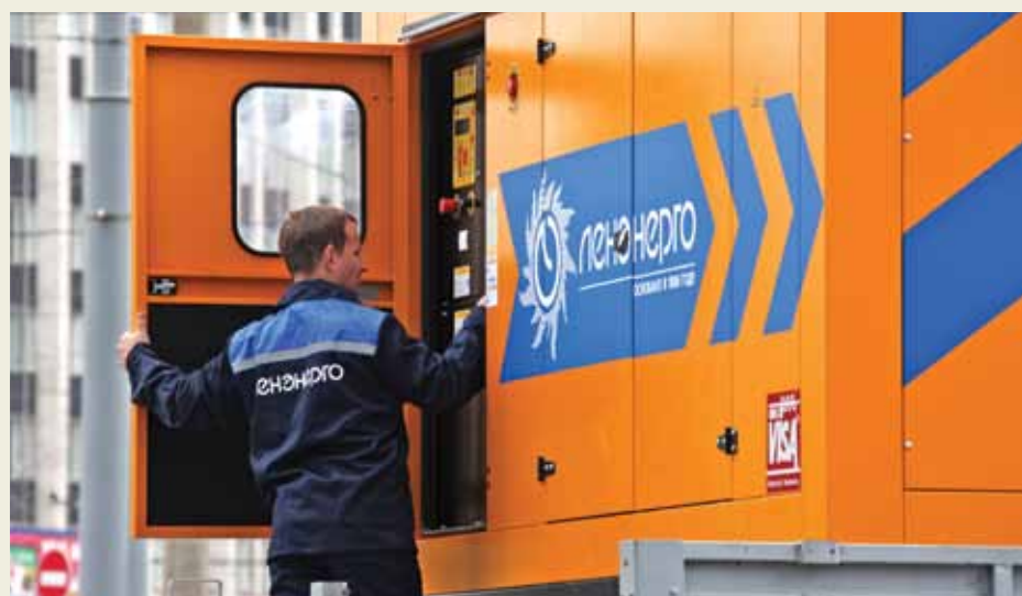
▲ Всего в парке компании 19 передвижных и 2 стационарных дизель-генераторных установки (ДГУ) общей мощностью 6550 кВА
