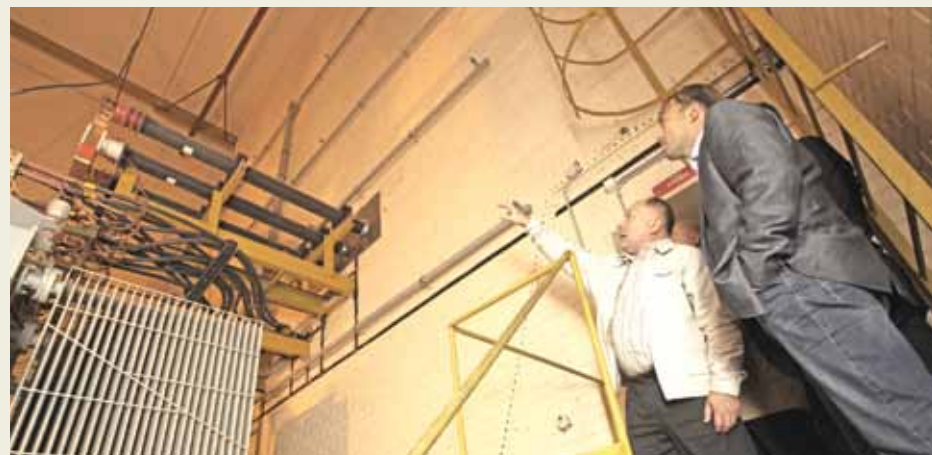
▲ Энергетики ОАО «Ленэнерго» показали коллегам из Риги оборудование подстанции 110 кВ №140 «Рижская»
