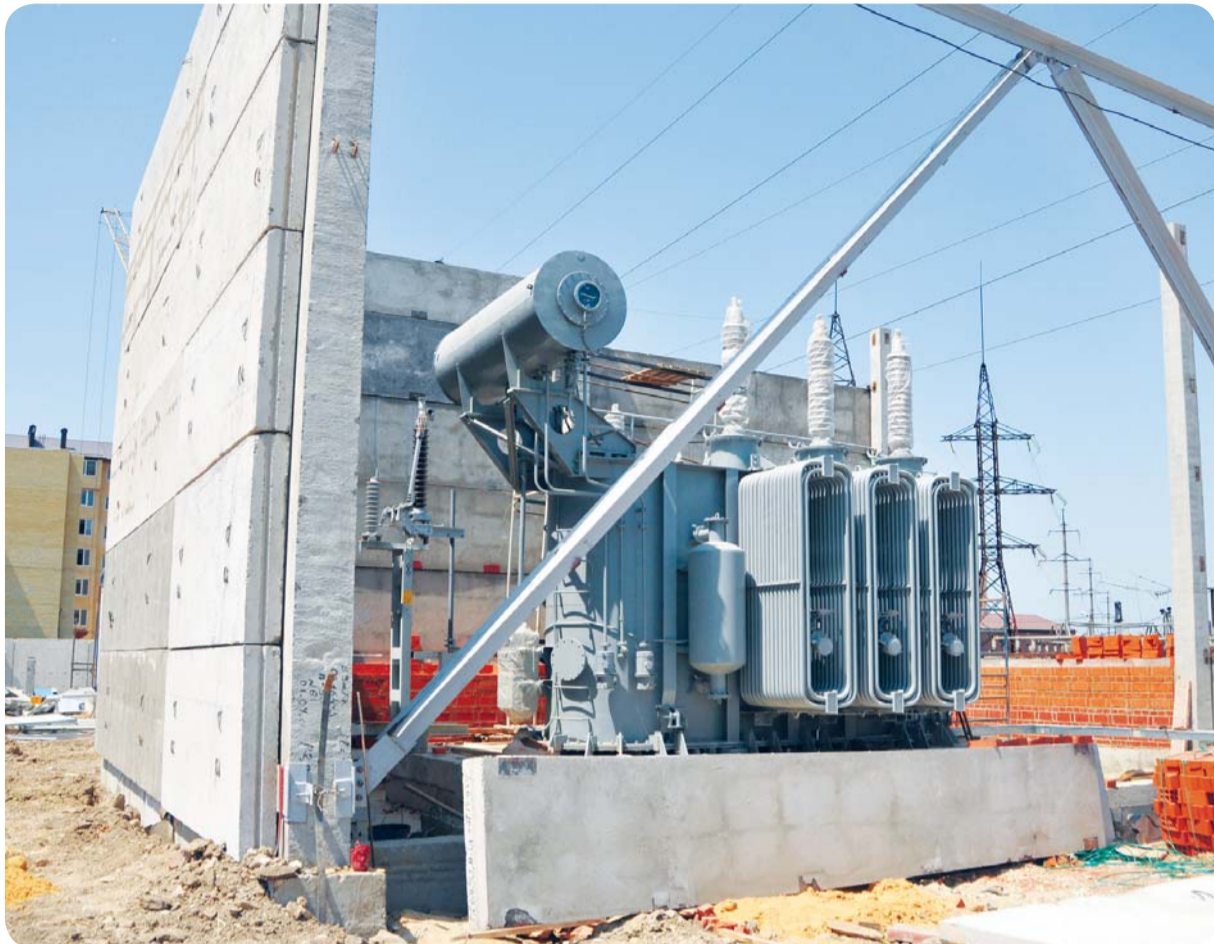
Шумозащитное ограждение вокруг силового трансформатора мощностью 25 МВА
