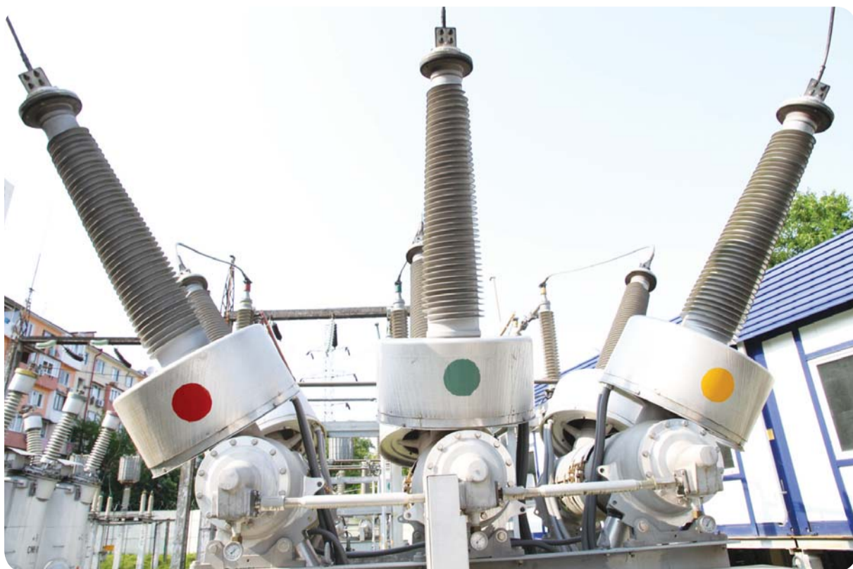
Перед Кубаньэнерго стоит важная задача – до 2014 года полностью реконструировать все сочинское электросетевое хозяйство. Последний раз такая задача перед энергетиками ставилась более 40 лет назад
